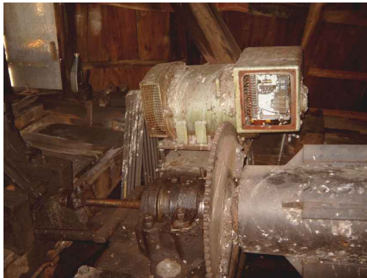
Penende der Flügelwelle mit versuchsweise eingebautem Generator zur Elektrizitätserzeugung.
