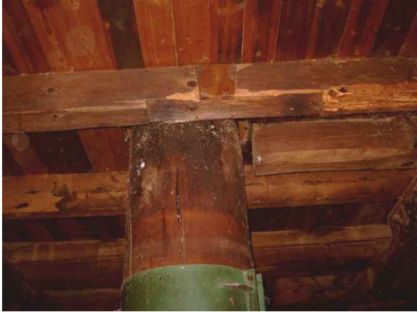
Königswelle an der Decke des Steinbodens mit jüngerer Reparatur durch Stahlblechschalen.
