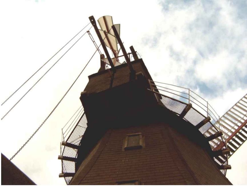
Windrosenanlage mit verkleidetem Windrosenbock, Fangstock der Bremsanlage und Jalousiesteuerhebel.
