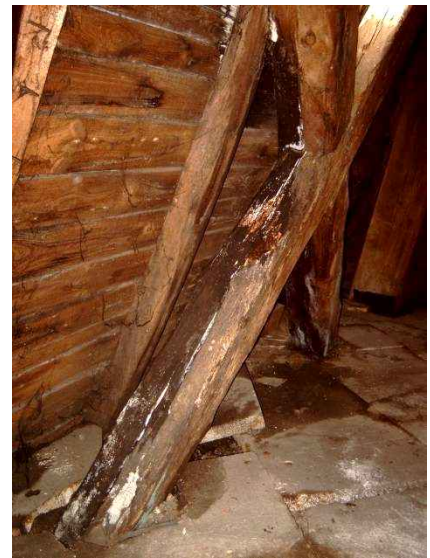
Durch undichtes Fenster beschädigtes Anderskreuz an der Südwestseite.
