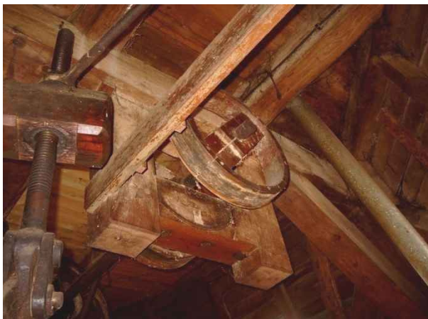
Rechtes Ende der Transmission mit auffällig massivem Lagerbock und Riemenscheiben zum Antrieb der beiden ehemaligen Mischmaschinen.
