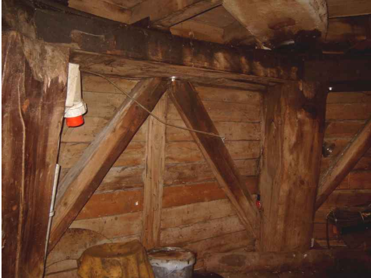
Kopfsende der Eckständer mit Kopfbändern und Obertafelment, darüber rechts linker Fugbalken mit Parierrolle.
