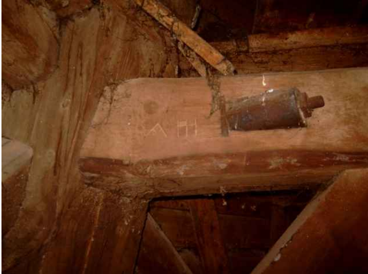
Schlagbalken (Unterzug) an der Westseite mit Abbundziffer und nachspannbarer Zugverbindung zum Eckständer.
