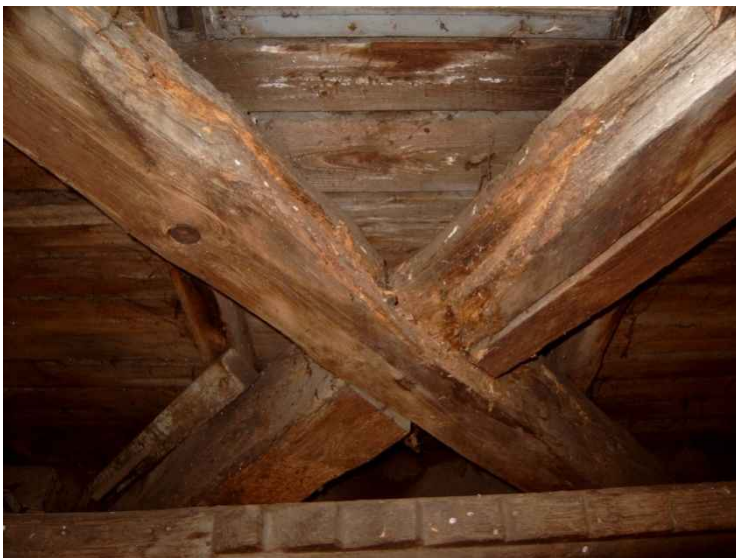
Durch undichtes Fenster beschädigtes Anderskreuz an der Westseite.
