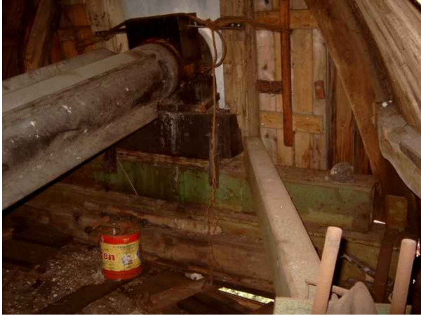
Halslager der 1989 erneuerten Flügelwelle. Rechts neben dem Lager zusätzliches Stahlprofil zum Stabilisieren des verzogenen Kapprahmens.
